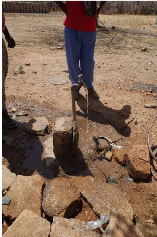
水パイプを設置した世帯。通常、家屋の外に蛇口が設けられる。
